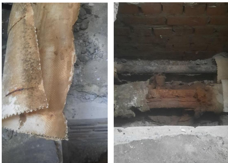
Рисунок 3 - Виявлена ділянка трубопроводу із залишками старого пошкодженого ізоляційного матеріалу
